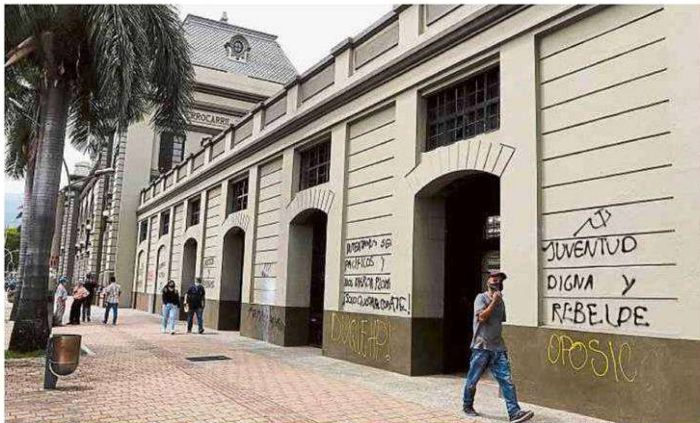
Autoridades piden que el patrimonio de la ciudad sea protegido para evitar daños mayores en estas estructuras. FOTO: JÁIVER NIETO. EL TIEMPO
