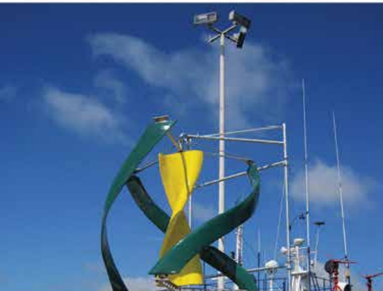
Vista del aerogenerador antes de iniciar las pruebas con el remolcador del terminal marítimo en el fondo.
