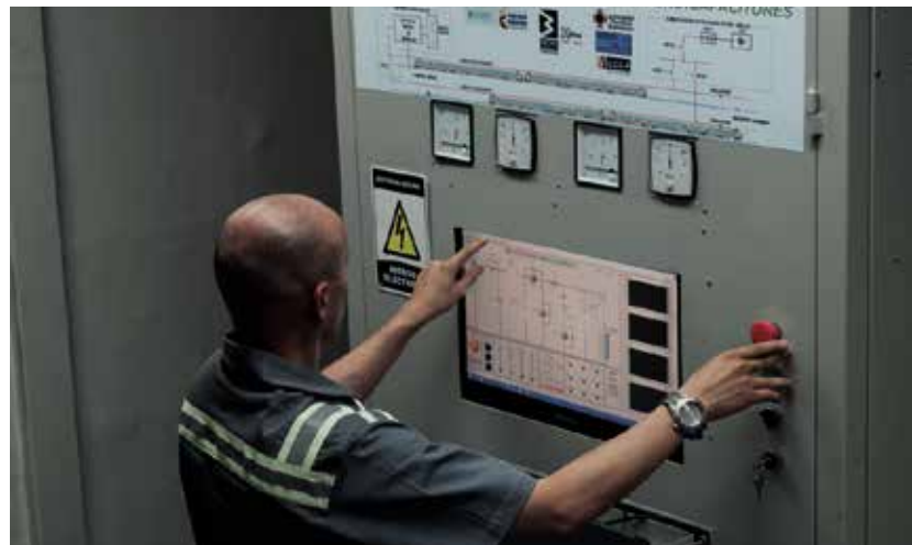
Se ha identificado otro punto débil en la línea B, en la que es necesario controlar las fluctuaciones o cambios en la tensión.
